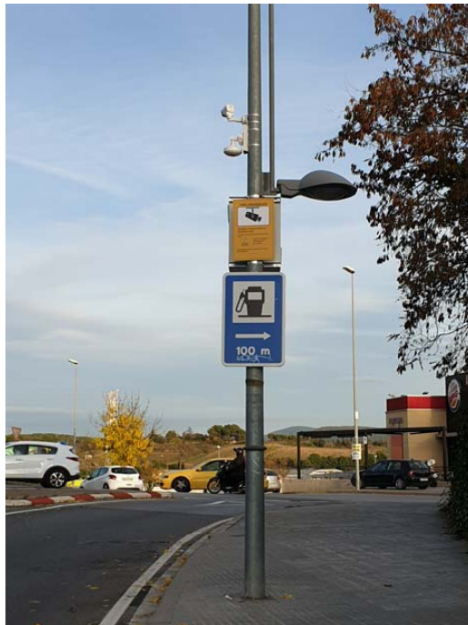
EXEMPLE D'EMPLAÇAMENT DE CÀMERA A FANAL
